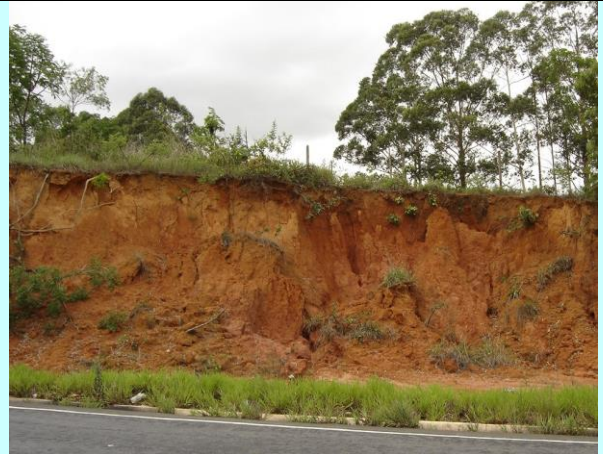
Figura 224 - Processo erosivo instalado em latossolo às margens da MG 050, causado por obras que deixaram o perfil muito verticalizado e susceptível à fatores erosivos, Cachoeira do Areião, Formiga- MG.
